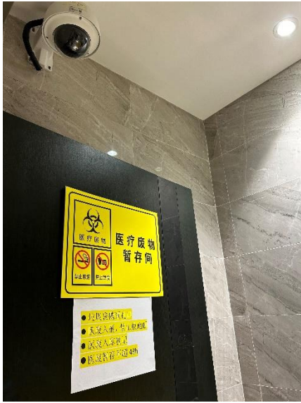
医疗废物暂存间视频监控
