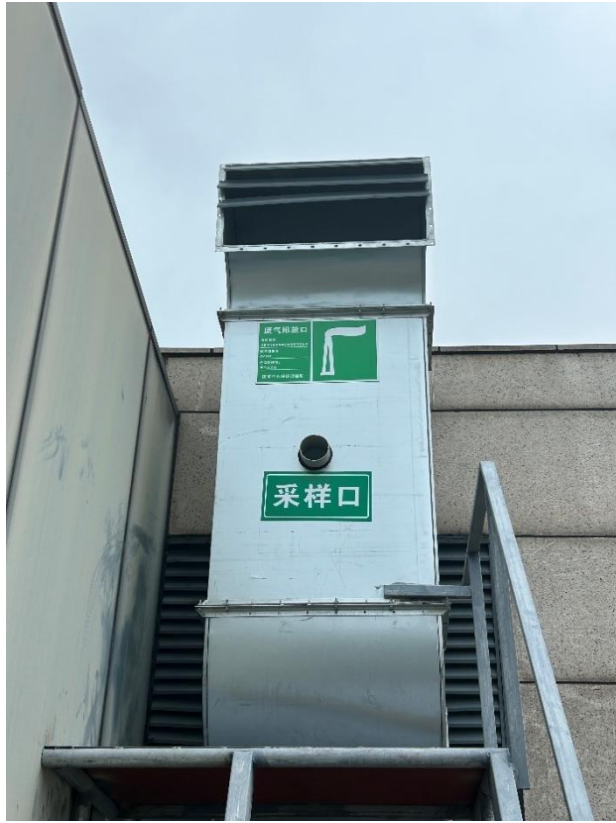
废气排出口及采样口
