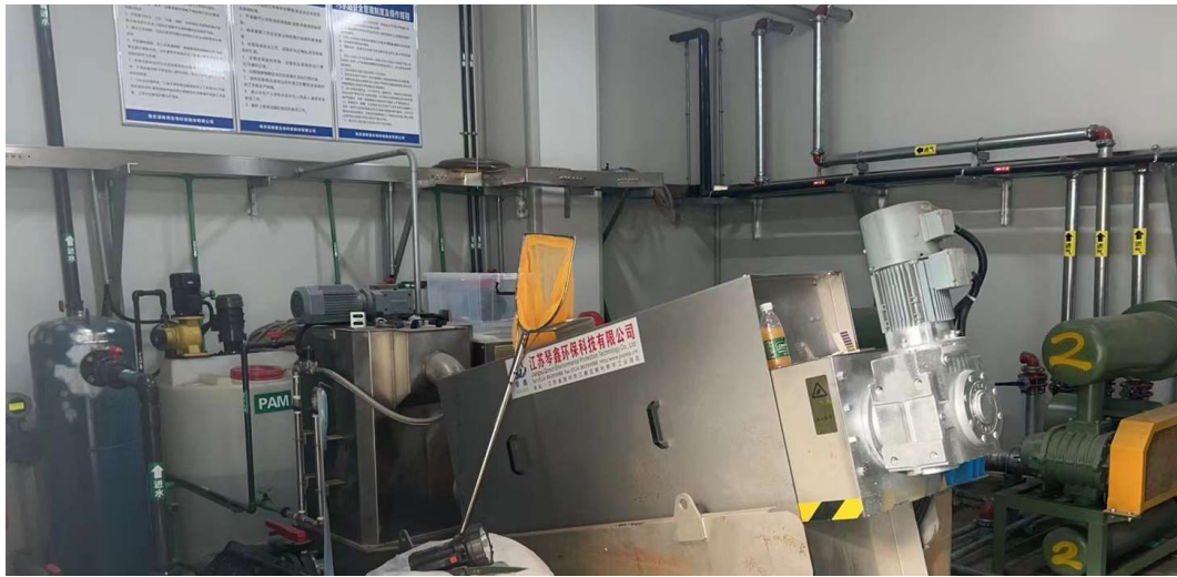
污水处理设施照片
