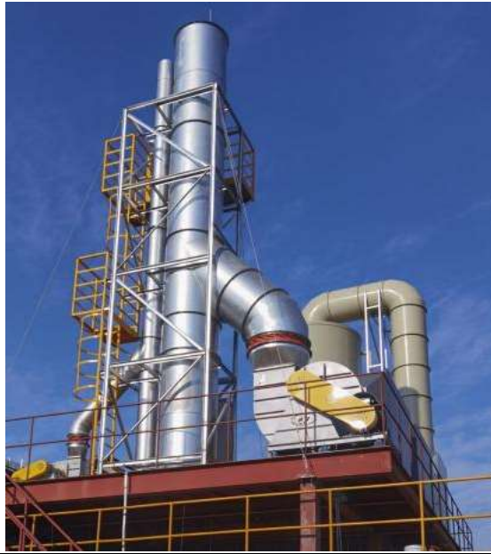
废气处理设施照片
