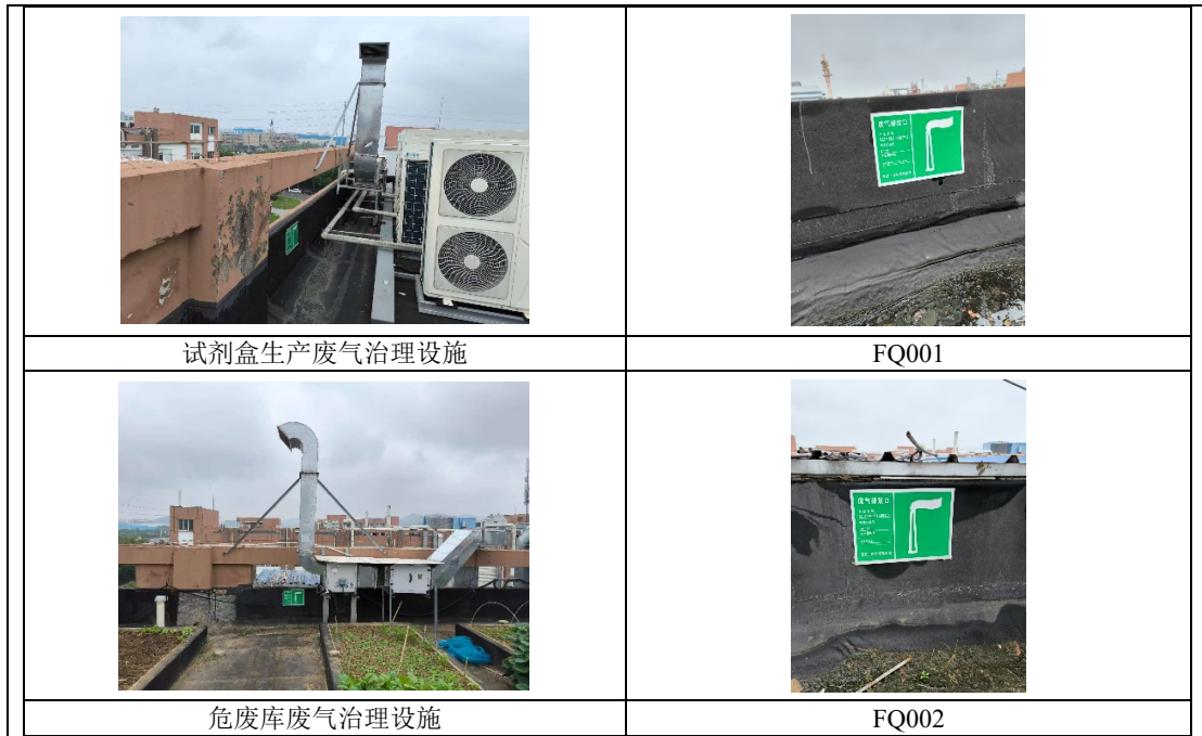
图 3-2 废气治理设施图
